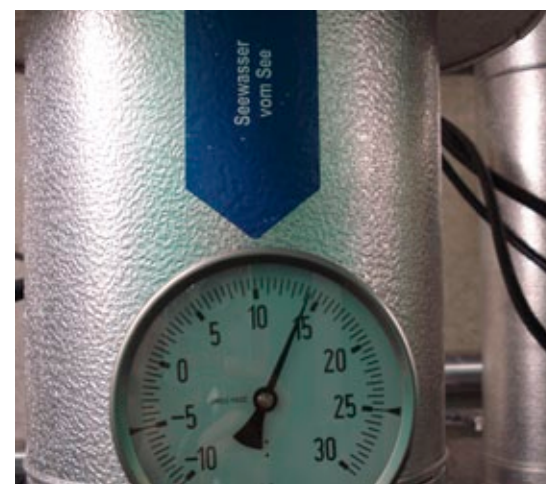
Wärmeenergie des Zürichsees wird zum Wärmen und Kühlen des Opernhauses genutzt
